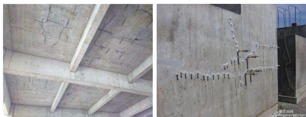
图1 大体积混凝土裂缝
