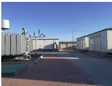
图1 兴旺预制舱式变电站
