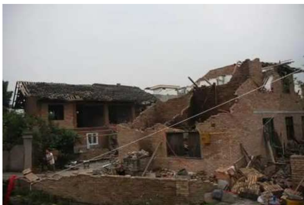
图1 地震破坏下的砌体结构房屋
