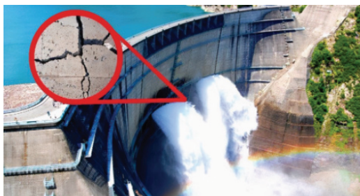
图1 水电站大坝开裂示意图
