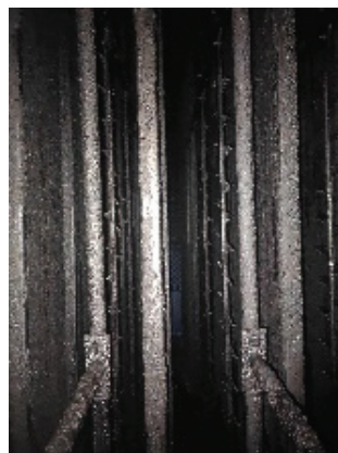
图2 偏高温电场内焦油附着情况
