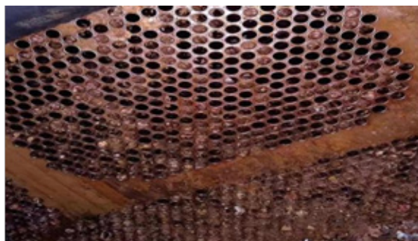
图4 机组大修前凝汽器内部堵塞状况
