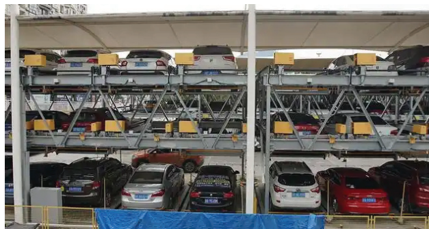
图1 某小区机械式停车设备
