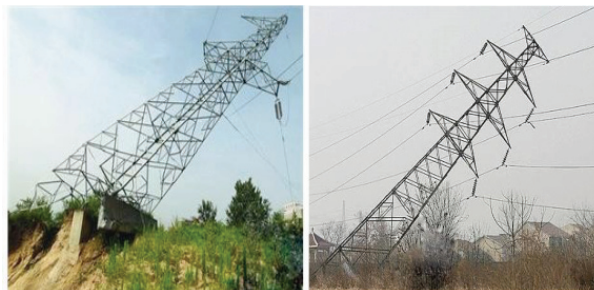
图1 杆塔倾斜或倒塌故障
